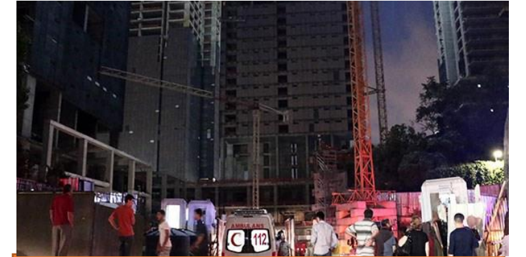
10 inşaat işçisi 32. kattan yere çakıldı
