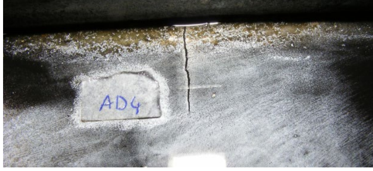
Şekil 6 Yorulma Çatlağı Örneği
