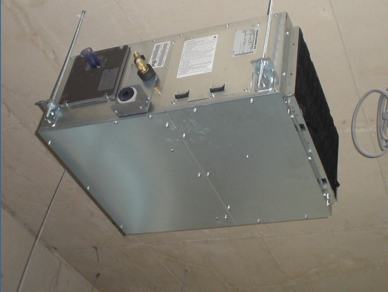
Su Kaynaklı Isı Pompası Sisteminin İç Ünitesi
