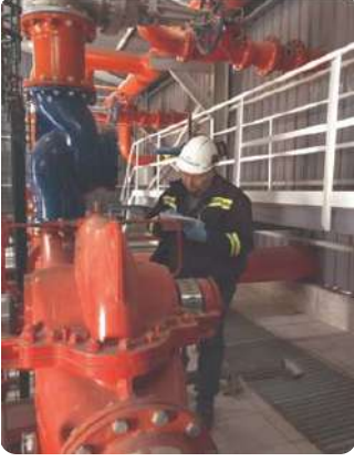
Yangın Pompası Performans Testleri
