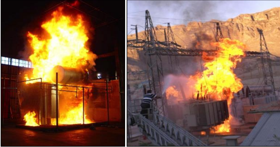
Fotoğraf 20.7 Trafo Yangınları
